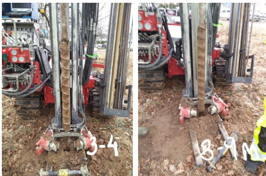
Figur 6. jordlagerföljd dominerad av sand 3-4m, Figur 7. jordlagerföljd dominerad av lera 8-9m. Båda bilderna är från skruvprovtagning vid provrör 22AF07GV.
